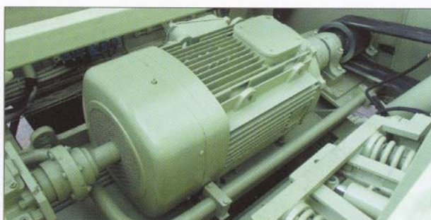
Grupo accionamiento eléctrico
